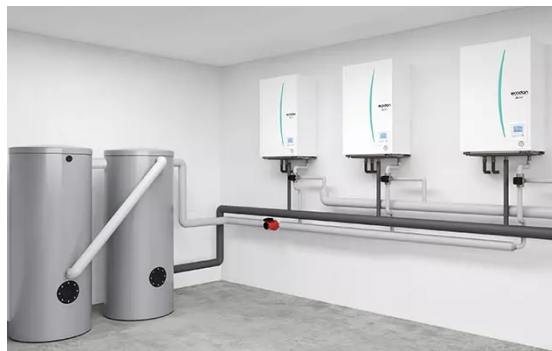
Pavyzdys. Šiuolaikinė katilinė su įdiegta Hydrobox talpykla.
